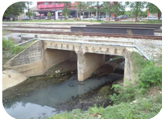
ท่อลอดเหลี่ยม
